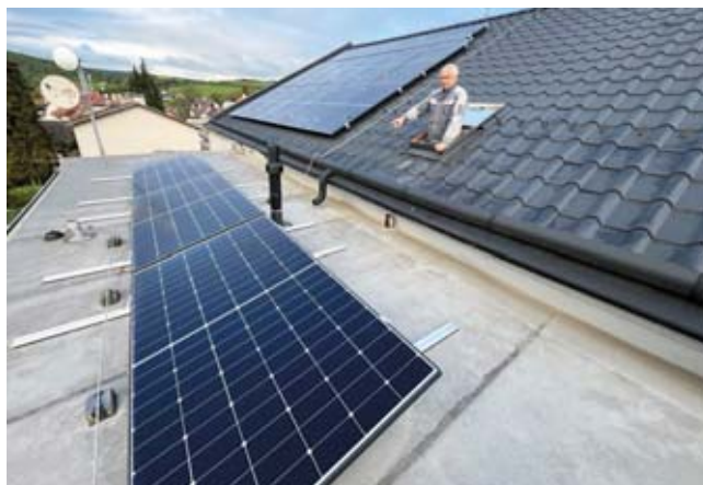
FVE na budově mateřské školy
