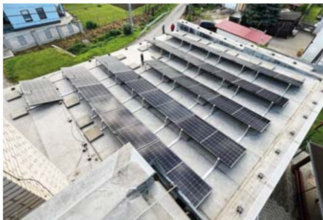
FVE na budově mateřské školy
