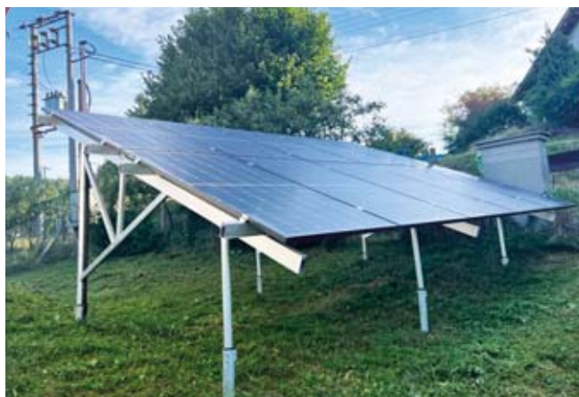
FVE u vodojemu
